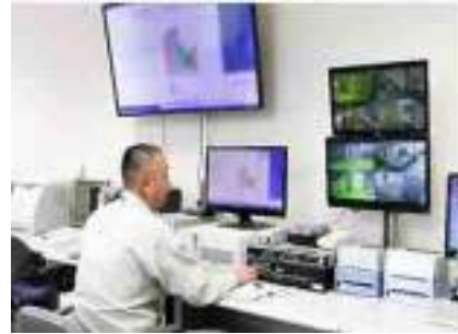
監視システムによる監視
